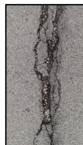
Nächstes Schadensbild: - Substanzverlust - Der Asphalt bricht aus Reparatur sehr aufwendig und teuer!!!
