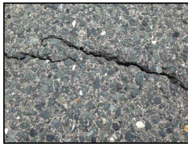
ein Riss im Asphalt
