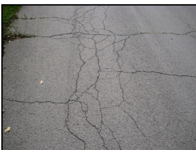
Netzrisse entstehen – Reparaturen schon sehr kostspielig!!!
