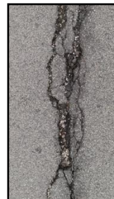
Nächstes Schadensbild: - Substanzverlust - Der Asphalt bricht aus Reparatur sehr aufwendig und teuer!!!
