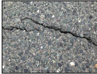
ein Riss im Asphalt
