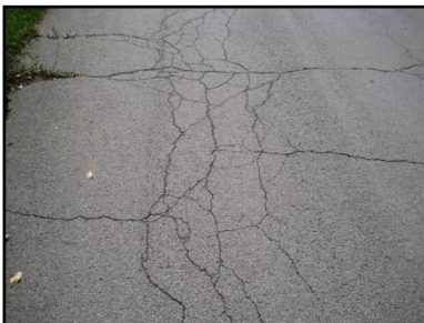
Netzrisse entstehen – Reparaturen schon sehr kostspielig!!!
